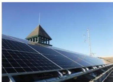
太陽光パネル
